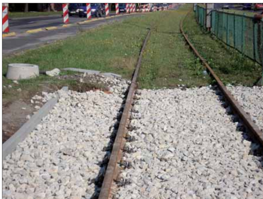
Rys. 1. Remont torowiska tramwajowego – nastąpi odczuwalne zmniejszenie zagrożenia korozyjnego miejskiej infrastruktury podziemnej wywołanego przez prądy błędzące
