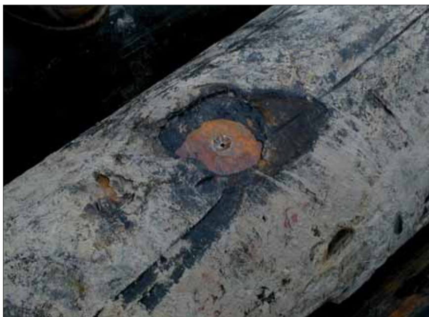
Rys. 2. Typowe uszkodzenie korozyjne wywołane przez prąd błędzący na gazociągu (fot. H. Matus)
